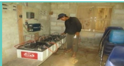
保管施設内電気システムの設置
